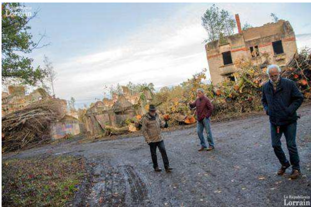
Maurice Schmitt, Bruno Doyen et Gabriel Becker de l'AFU, devant la cité pavillonnaire défrichée pour accueillir des panneaux photovoltaïques. Photo RL
